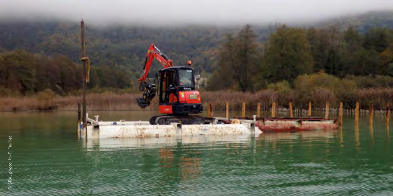
Figure 4 : Piquetage en cours sur le site de Beau Phare (ou Boffard) sur le lac d'Aiguebelette en novembre 2022. Staking in progress at the Beau Phare (or Boffard) site on Lake Aiguebelette in November 2022.
